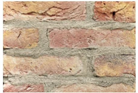
オーバーグラウトジョイント (Overgrout Joint)
